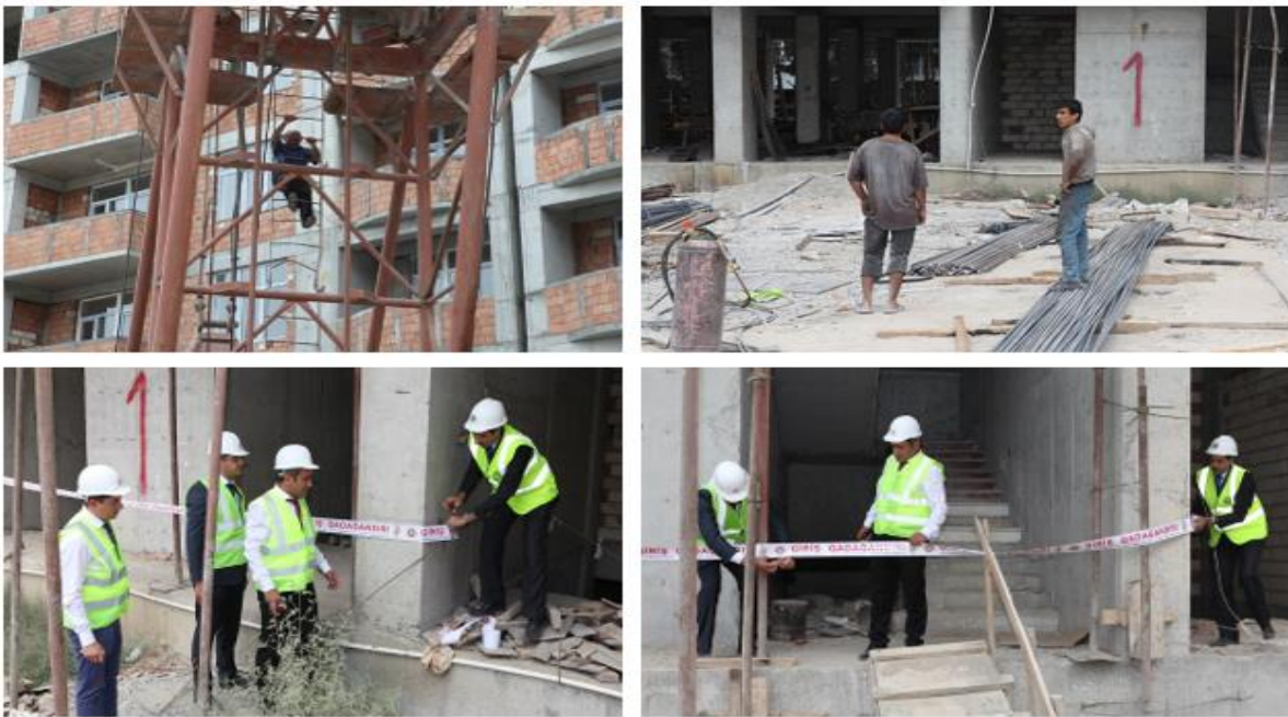
Şəkil 2. “Alpina” MMC və “Qaraçay” MMC şirkətlərinin hündürmərtəbəli binalarının tikintisində əməyin mühafizəsi qaydalarını ciddi şəkildə pozması və yoxlamaların keçirildiyini əks etdirən şəkillər
